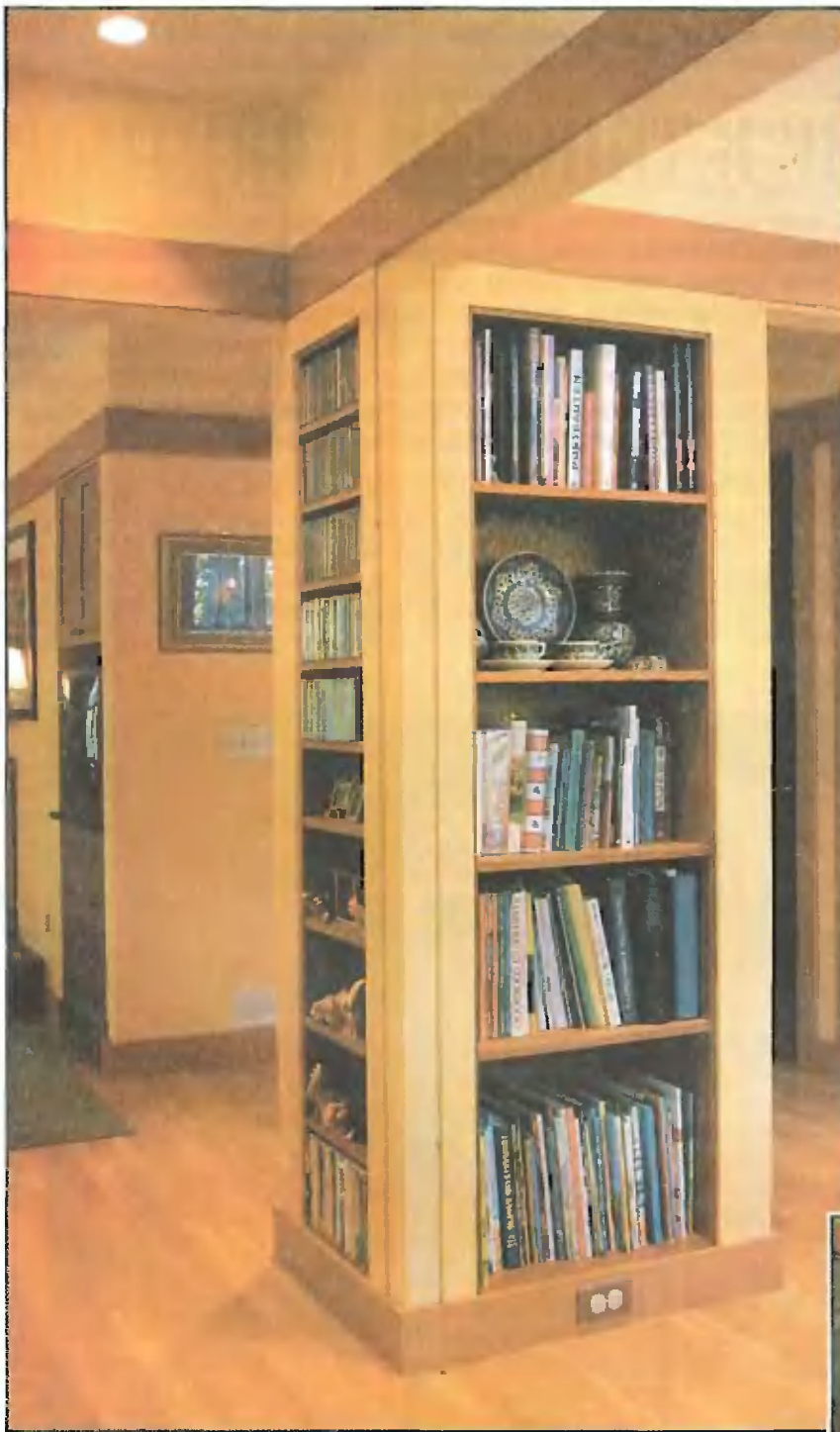
Функциональная опора. Четырехсторонний стеллаж, установленный на полу, служит не только для хранения книг, но и несет нагрузку от балок перекрытия. Фото с точки F на плане
