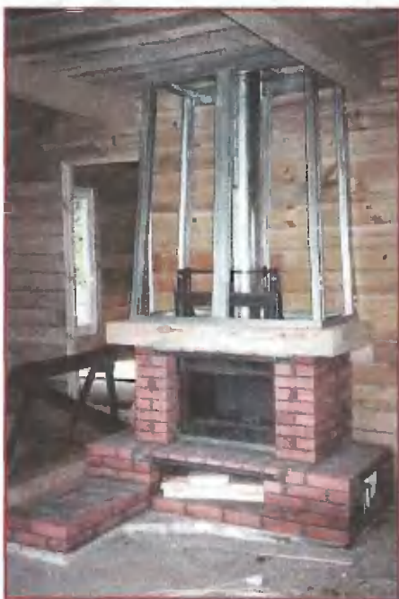
Кирпичная кладка, установка дымохода, деревянной полки и каркаса экрана камина завершены. Пора приступать к внешней отделке
